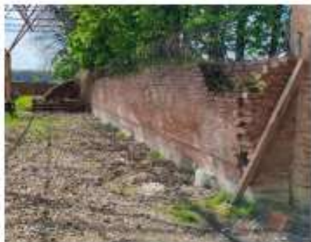
Земельный участок (поврежденное ограждение)
