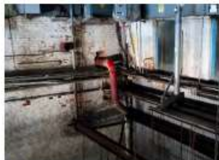
Литер С «износ аварийный»
