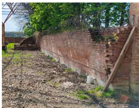
Земельный участок (поврежденное ограждение)
