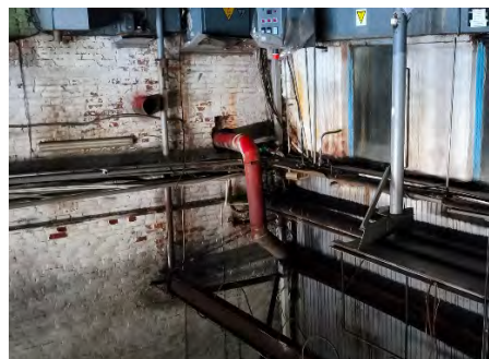
Литер С «износ аварийный»
